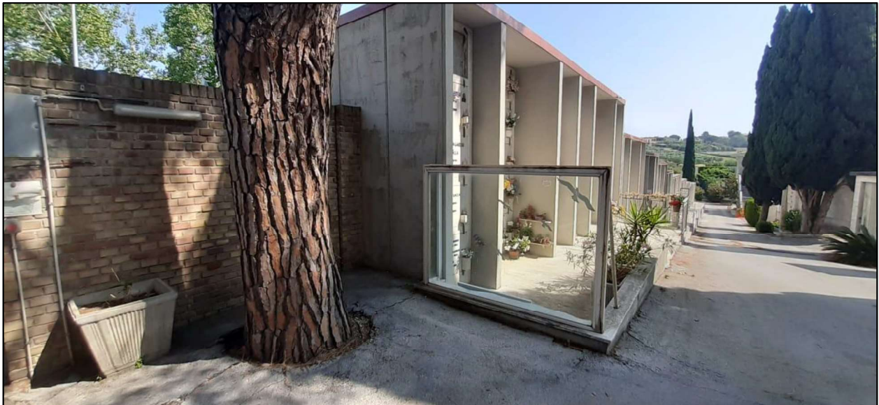
Figura 5. Pino Pinea ostacolato dal muro di cinta e dal colombario
